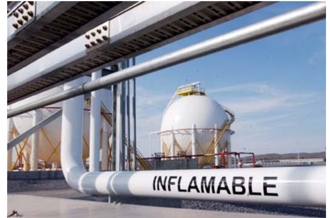
Complejo Procesador de Gas Burgos
