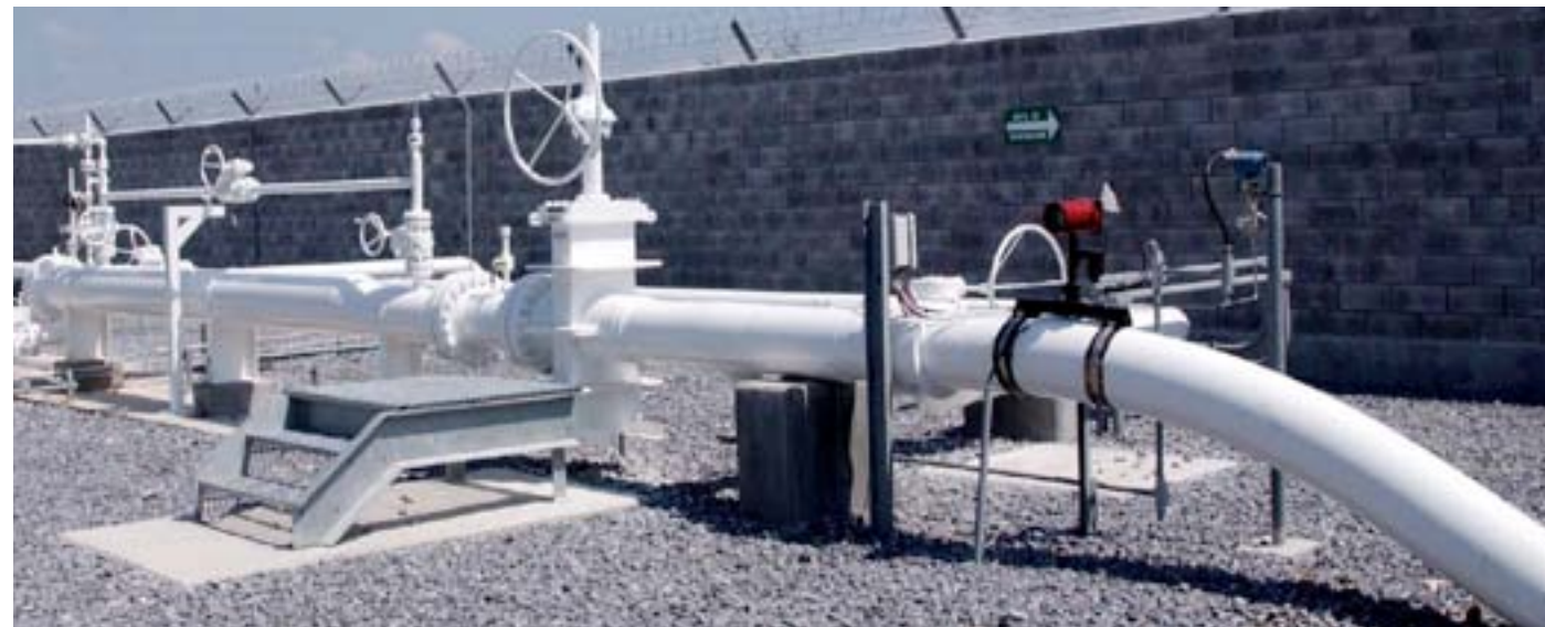
Complejo Procesador de Gas Burgos
